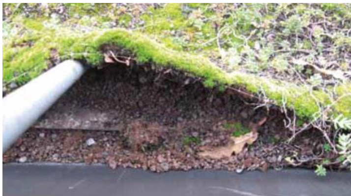
FIGUUR 5 EEN COMBINATIE VAN VERKEERDE DAKOPBOUW, MATERIAALKEUZE EN DUNNE SUBSTRAATLAAG ZORGT VOOR TE HOOG VOCHTGEHALTE MET VEEL MOSVORMING EN ONGEWENSTE BEPLANTING TOT GEVOLG (BRON: VAN HECK (2010) DAK&GEVELGROEN).
