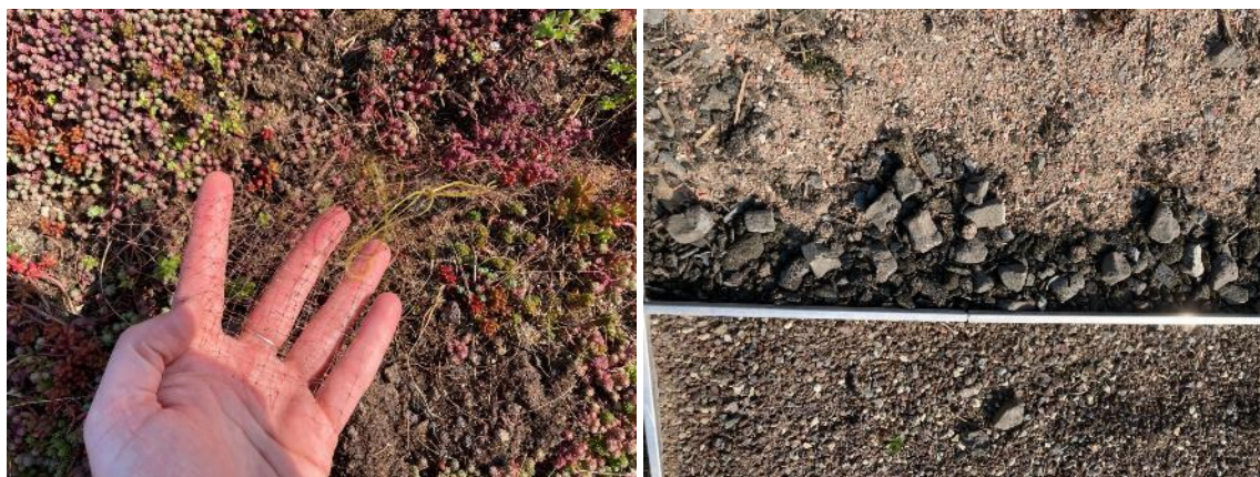
FIGUUR 11 OPMERKINGEN BIJ HET DEMODAK TIJDENS EERSTE MAANDAN NA AANLEG. BOVEN: PROBLEMEN MET MOSVEGETATIE. LINKONDER: STUK LOSLIGGEND NET BIJ DE SEDUMMAT (DEMO A5). RECHTSONDER: DOOR ZWAARTEKRACHT IN COMBINATIE MET WIND EN NEERSLAG, SCHUIFT DEEL VAN HET CELLEGLAS NAAR BENEDEN OP DE HELLING.
